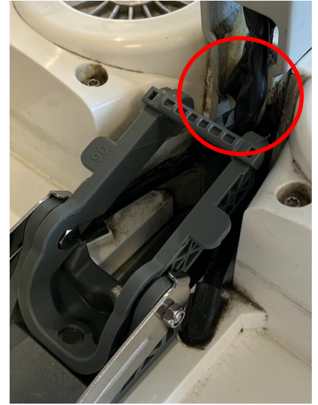
Kabel skal være på indvendig side / bag drive support.
